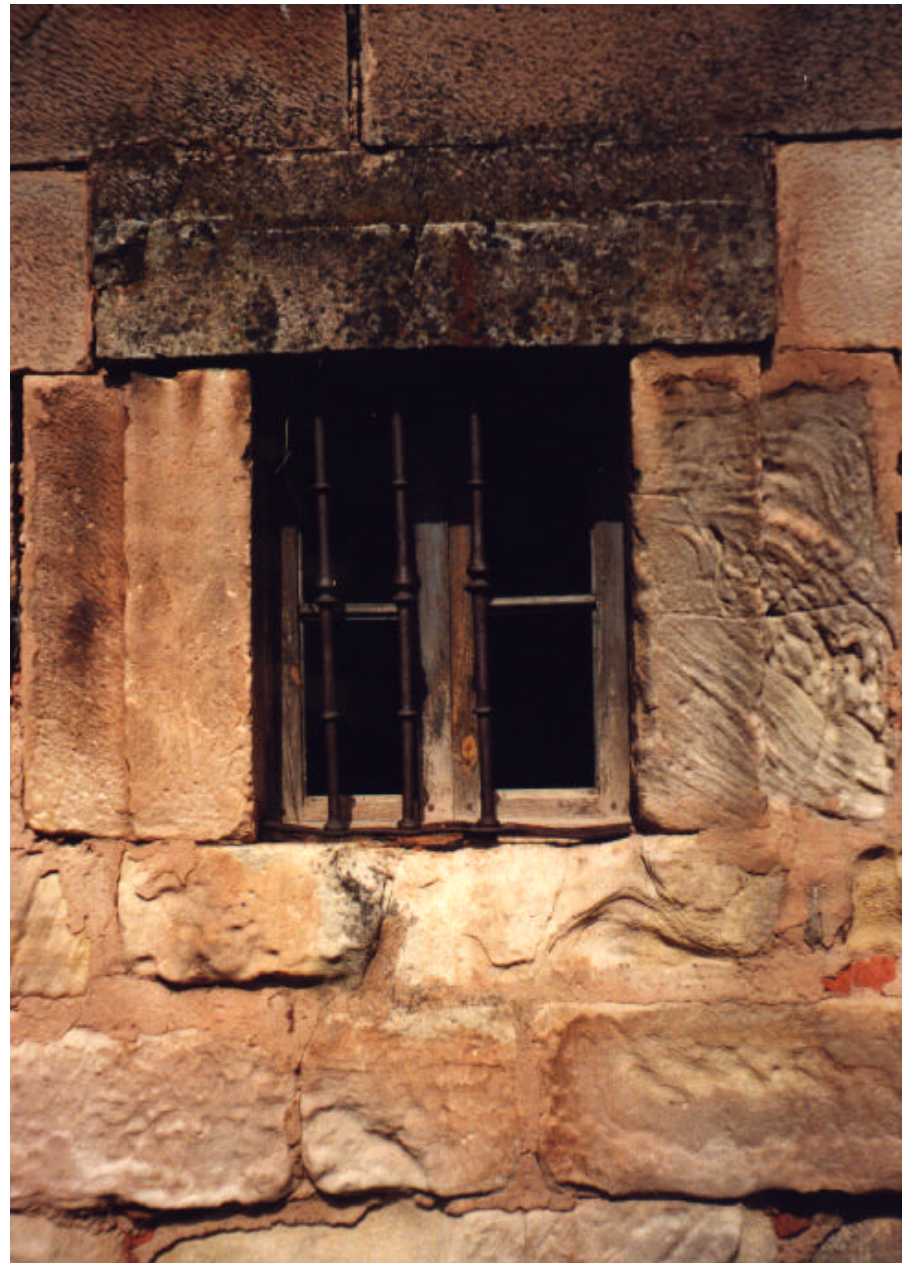
Vilviestre del Pinar. En la fotografía se puede observar como coinciden en el mismo elemento piezas pétreas dañadas y en buen estado.
